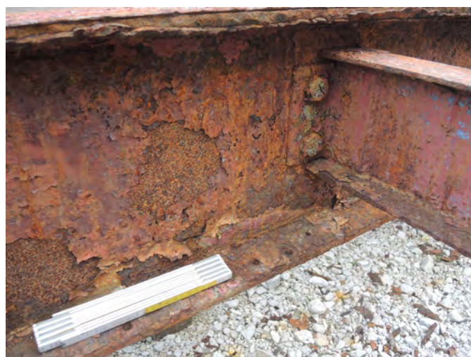
4 Die vorgefundenen Korrosionsschäden an der Waagkonstruktion waren zumeist nur oberflächlich, März 2017. © Markus Numberger, Esslingen
